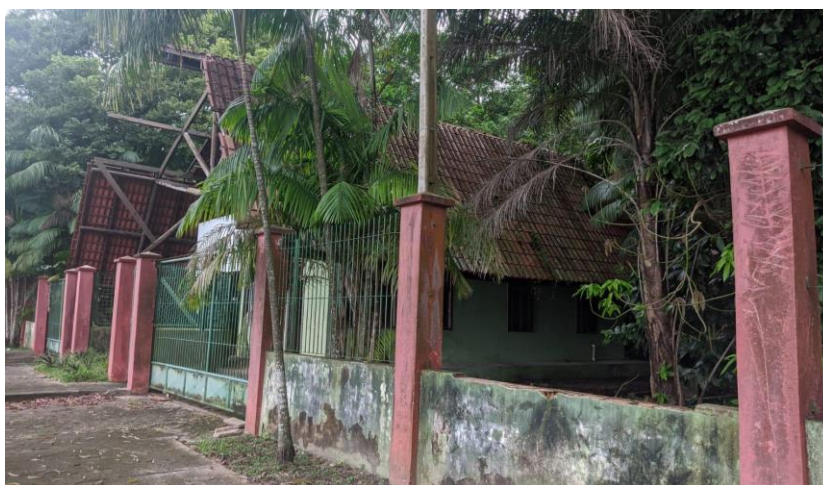
Figura 3: Guarita de entrada do parque abandonada, com estrutura deteriorada e sem grade de contenção.
