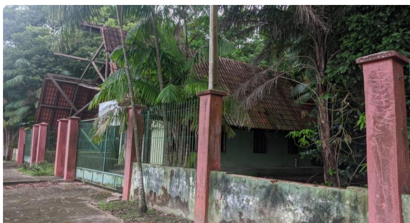
Figura 3: Guarita de entrada do parque abandonada, com estrutura deteriorada e sem grade de contenção.
