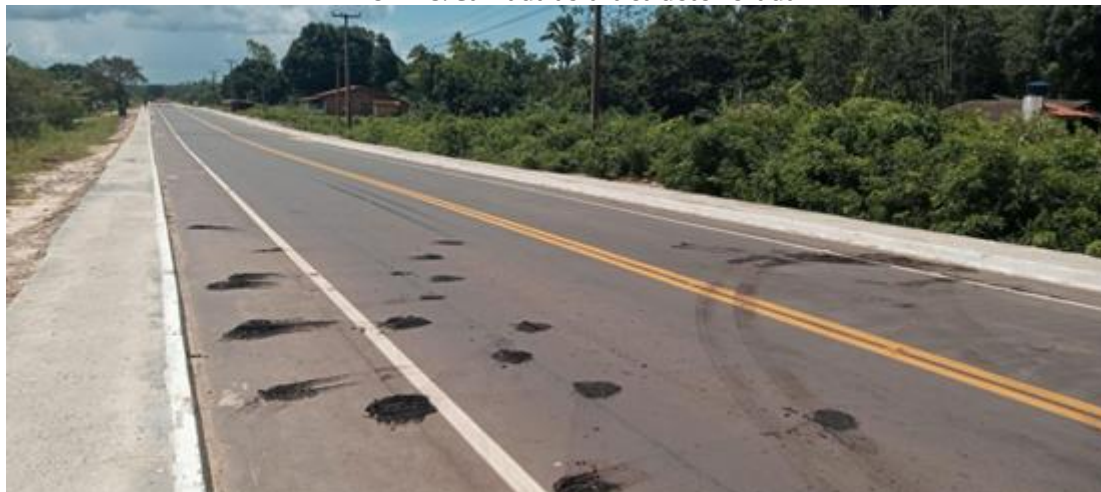
IMAGEM 5: Camada asfáltica deteriorada
