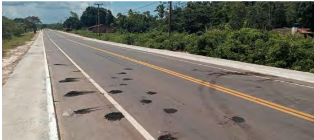
IMAGEM 5: Camada asfáltica deteriorada
